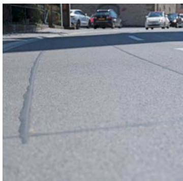
Im Strassenbelag verlegte Schleifen: Schmale Schlitzlöcher, in die Drähte (Litzen) eingelegt werden.
