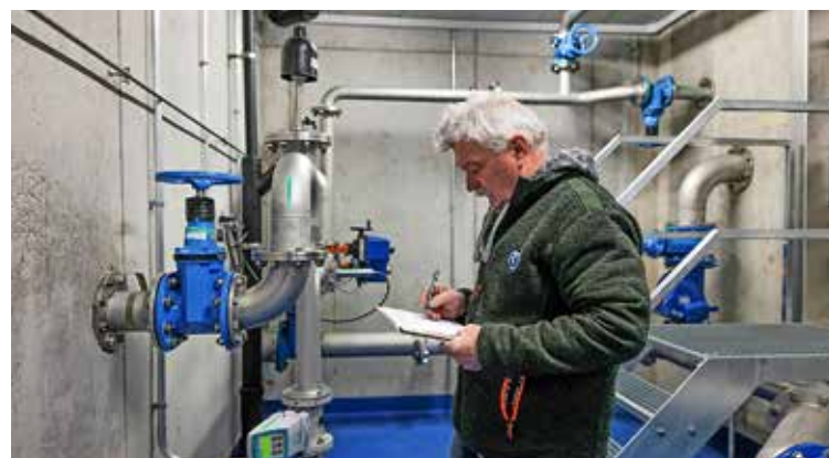
Der Hemishofer Wassermeister Alex Ehrat beim wöchentlichen Kontrollgang im Reservoir.
