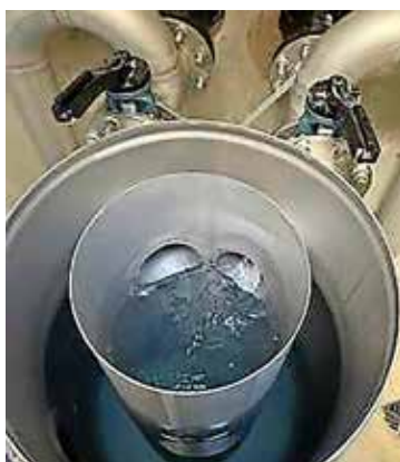
Trinkwasser-Einlauf in der «Brunnenstube».
