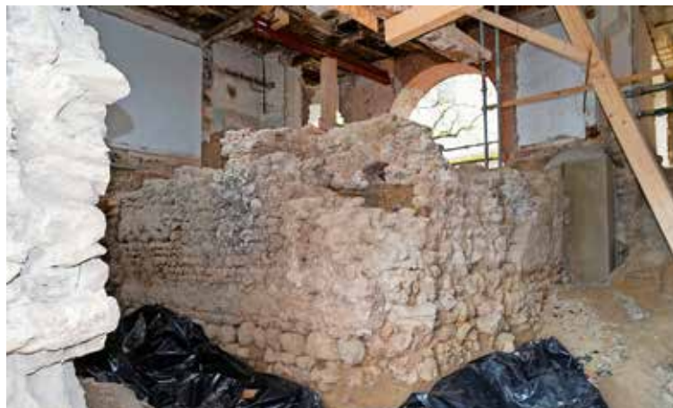
Das Mauerfragment aus dem 12. Jahrhundert im Chorherrenstift macht eine umfangreiche Umplanung erforderlich. Bild Michael Jahnke
